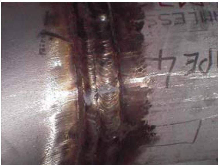
Nepracovaný svarový spoj: Vrstva okujů může být výchozím stavem pro vznik koroze, jestliže není správně odstraněna.
